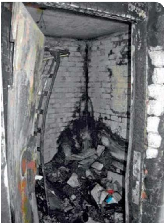
Figura 4 | Incendio in una cella di sicurezza
